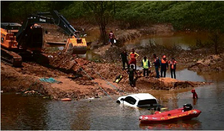
Escavadeira puxa um dos veículos que afundou no Rio Curuçá após ponte desabar na BR-319, no Amazonas
